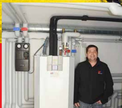
Christoph Ruthmann bei der Luft/Wasser-Wärmepumpe von Johann Gruber. Dieses System heizt und kühlt über die Fußbodenheizung.
